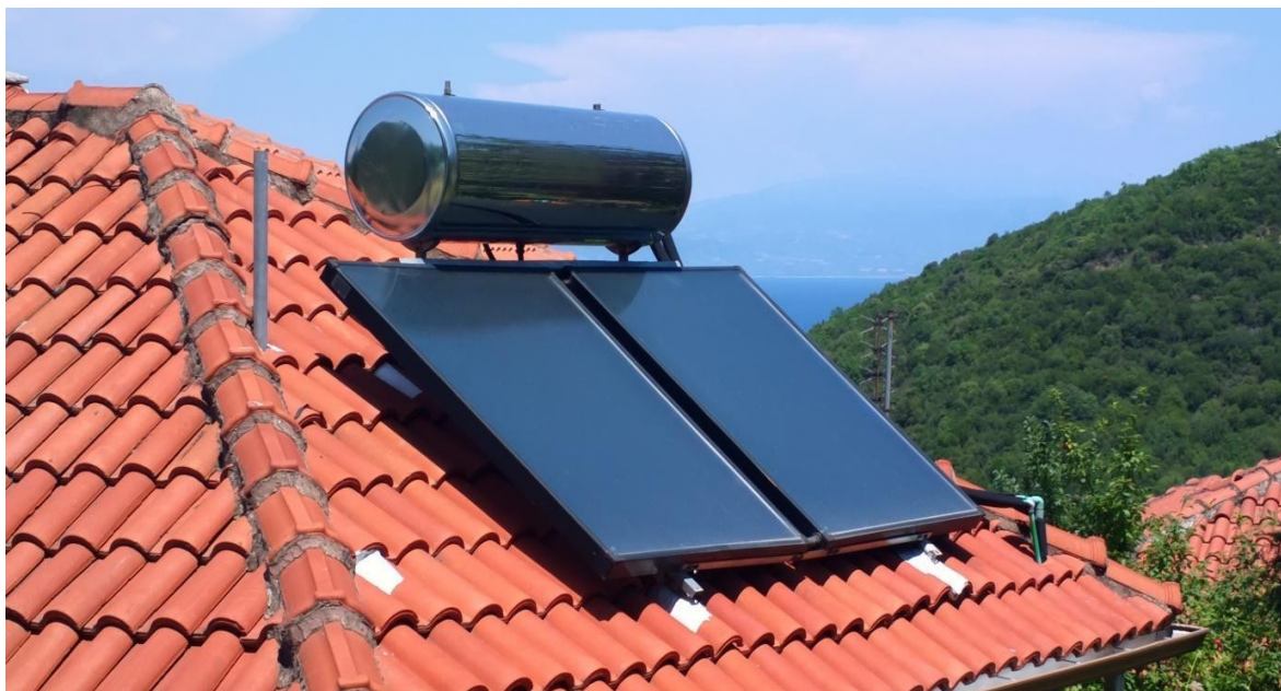
Immagine 9 - Impianto di energia solare termica ©Adobe Stock, Springtime/8
